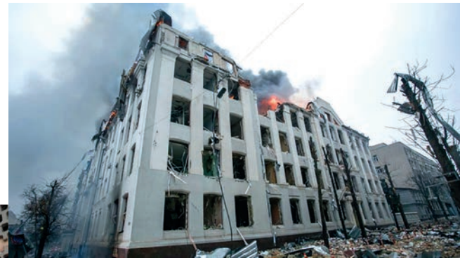
2 Пошкоджена будівля, архітектор Кушнар'єв, за проєктом Тимошенка, зведена 1925 року, м. Харків /фото зі статті Зруйнований Харків: як виглядає місто після російських бомбардувань [https://suspiine.media/214144-zrujnovanij-harkiv-ak-vigladae-misto-pisla-rosijskikh-bombarduvan/]
